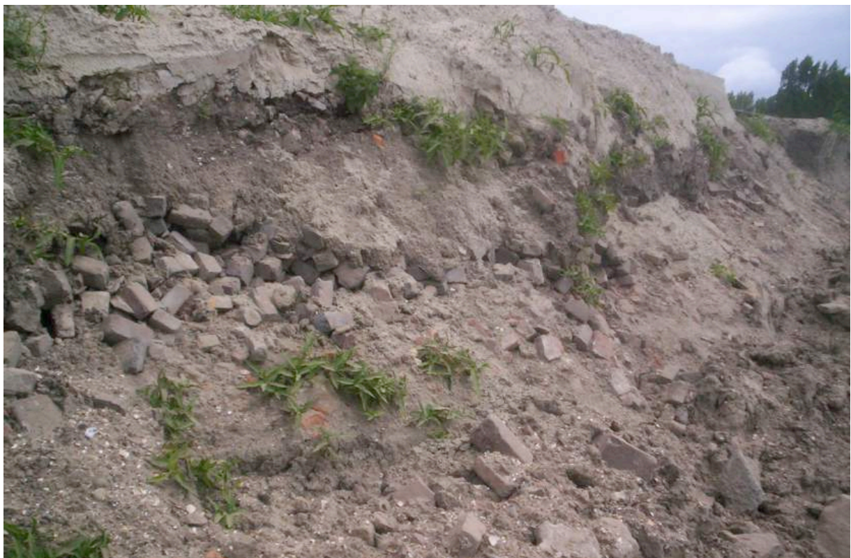
Afb. 5.20 Na het verwijderen van de glooiing kwam het binnenste van de Zuiderdijk te voorschijn. Op deze foto is het paardenpadje van de weg naar beneden gerold. De golven hadden de grond boven de glooiing en naast de weg weggespoeld.
