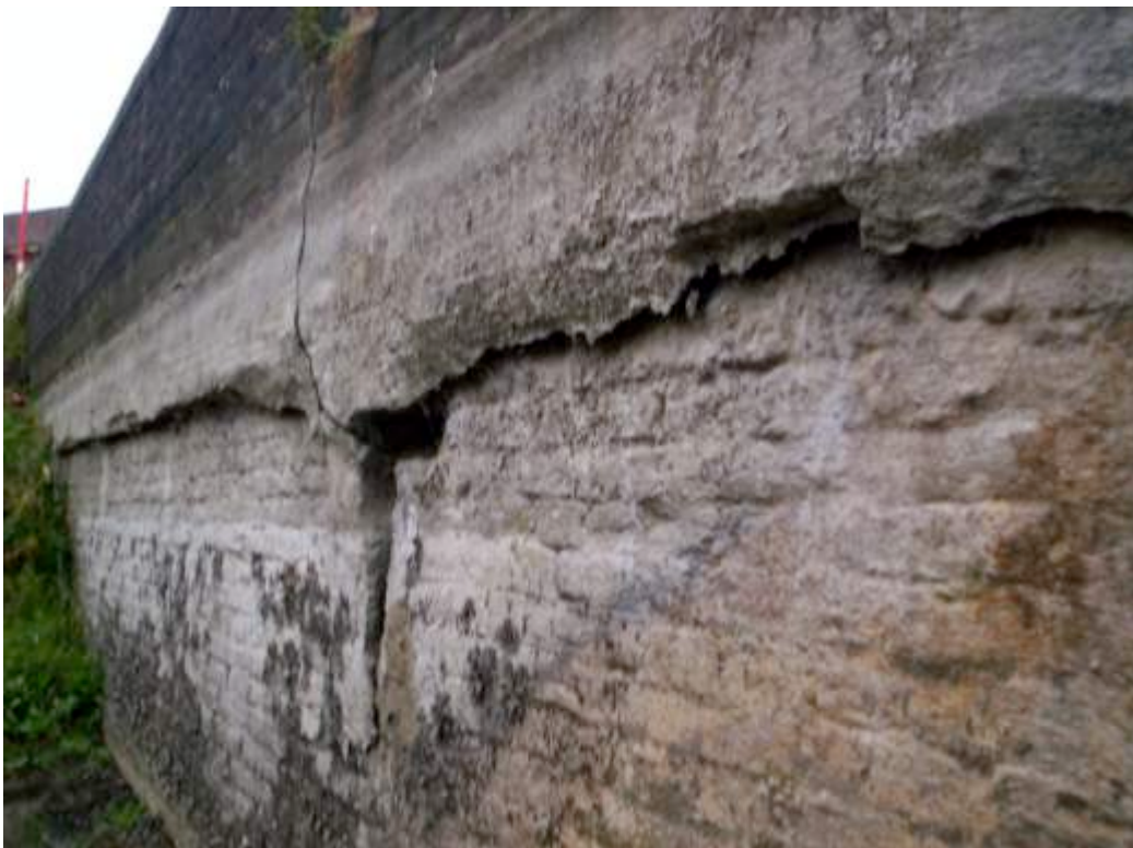
Afb. 5.67 Na de bouw van de nieuwe koker zag de oostelijke muur van de kolk er zo uit. De bovenkant is waarschijnlijk in 1923/24 vervangen en met cementspecie gemetseld. De onderkant is de 400 jaar oude muur, gemaakt met kalkspecie. Het onderste gedeelte met houten fundering is achterover gezakt.
