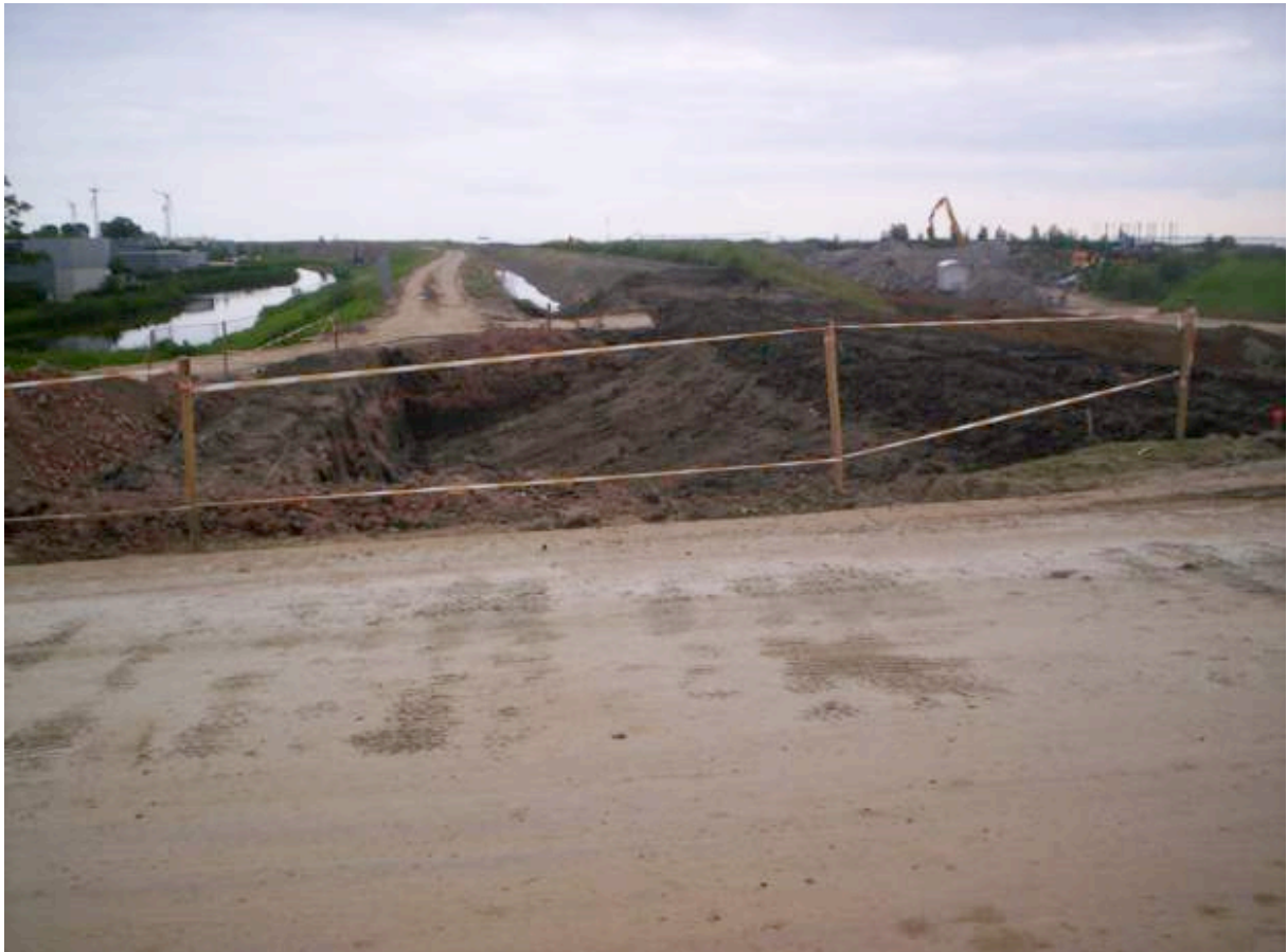
Afb. 3.76 Nabij de oprit van Hoorn 80 is de weg van de oude dijk gedeeltelijk verdwenen. Onder de weg is meer dan een meter puin begraven. Omdat het puin aan de zijkanten was opgesloten door klei was dit een verantwoorde oplossing voor een zeedijk. In dit geval zal het puin uit Hoorn afkomstig zijn. Hier is de nieuwe dijk voor de oude in aanbouw.
