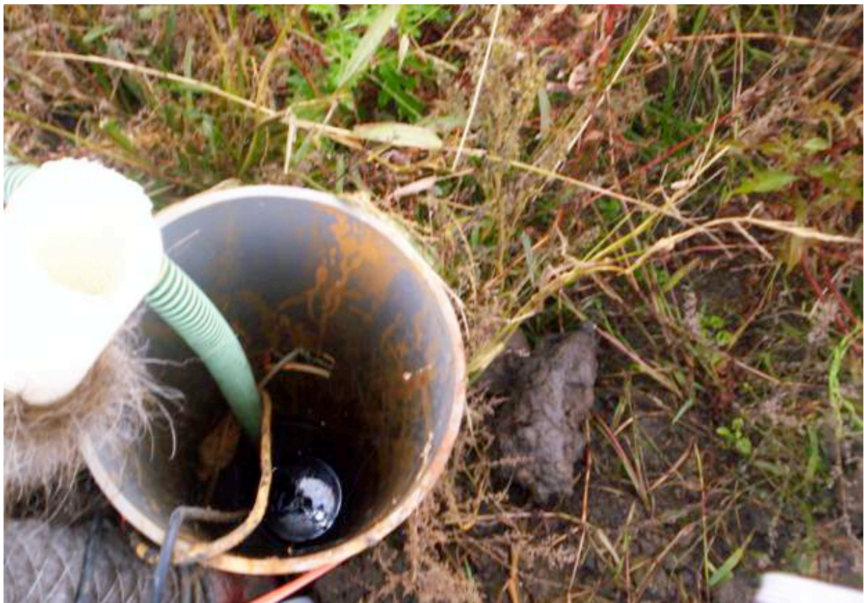
Afb. 5.46 De bemalingsput bestaat uit een PVC buis rond 30 cm met onderin de drainage boven de afgesloten bodem. Een pompelpomp pompt het drangwater uit de put in het Markermeer.
