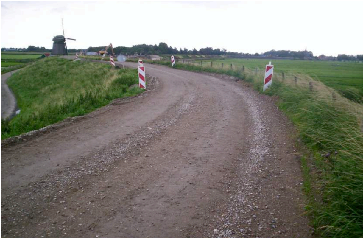
Afb. 5.34 De dumpers met keileem reden in korte tijd het asfalt van de Zuiderdijk kapot dat met puin werd opgevuld voor een nieuwe rijbaan.
